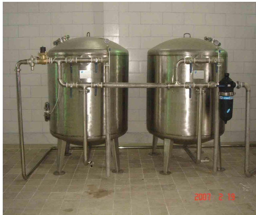
مخازن استنلس استیل فیلتر شن و ذغال اکتیو و فیلتر پلیکربنات دیسکی همراه سامانه لوله کشی مربوطه
